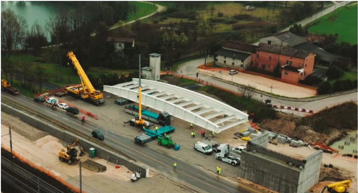
Copertina: Impiego di geocomposito cementizio Concrete Canvas® in ambito ferroviario (Foto Concrete Canvas®/Harpo seic) Sopra: Impalcato metallico prima del varo in un cantiere dell'Alta Velocità ferroviaria (Foto EuroprogressGroup)
